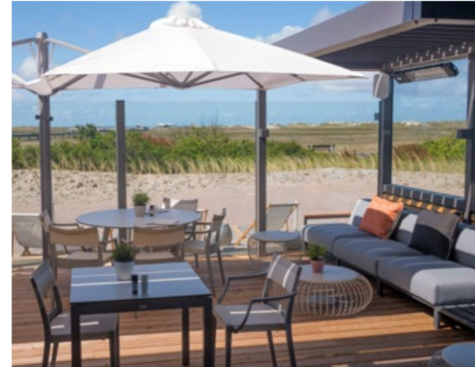
HeatShine – Wagner Metallbau Nindorf, Strandgut Resort, Sant Peter Oerding, DE
